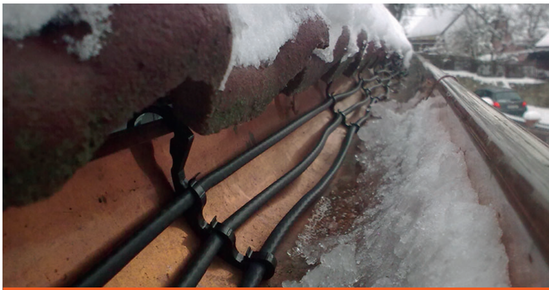
montáž a funkce topných kabelů v okapovém žlabu RD
